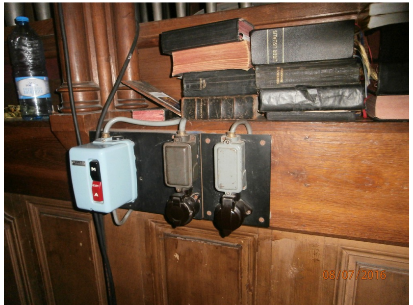
Les installations électriques directement sur le soubassement du buffet
