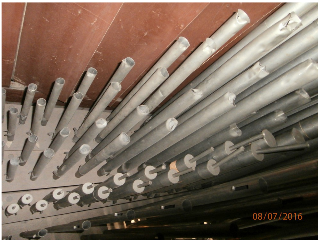
La tuyauterie du Récit avec la Gambe à la place du Salicional et le Bourdon sur la place de l'Octavin, lors du démontage
